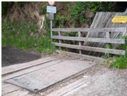
Vorher: eine beschädigte Brücke.
