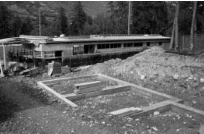
Blick auf das neue Vereinsheim (mit Bar - im Hintergrund). Das Fundament zeigt wo die neuen Umkleidekabinen für den Eisplatz entstehen
